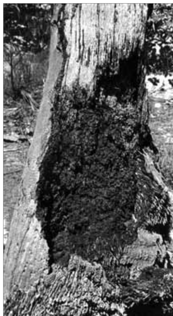
Tallo de cocotero descascarado por Marcano para que se viera el daño interior que le habían causado las termitas, en la playa de La Sardina.
